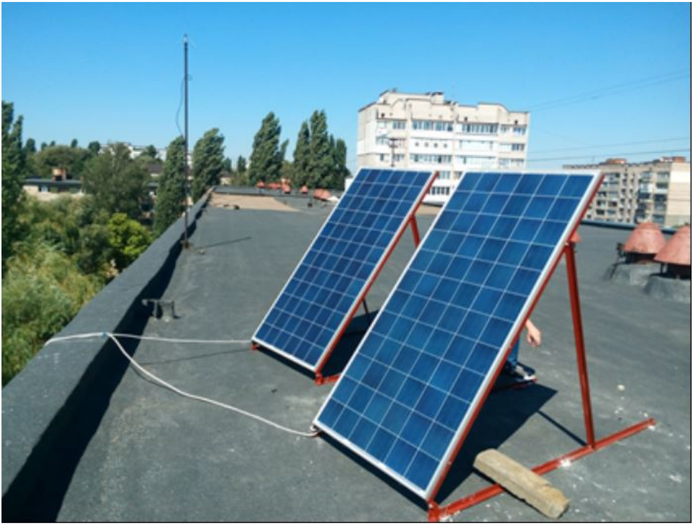
Рис. 14. Сонячні батареї, розміщені на даху 4-го корпусу
