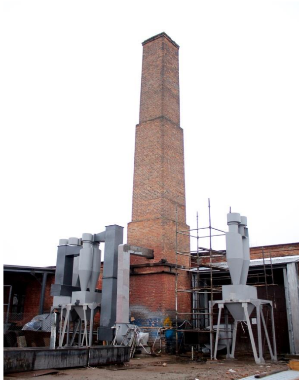
Рис.11.6 Котельня університету на твердому паливі
