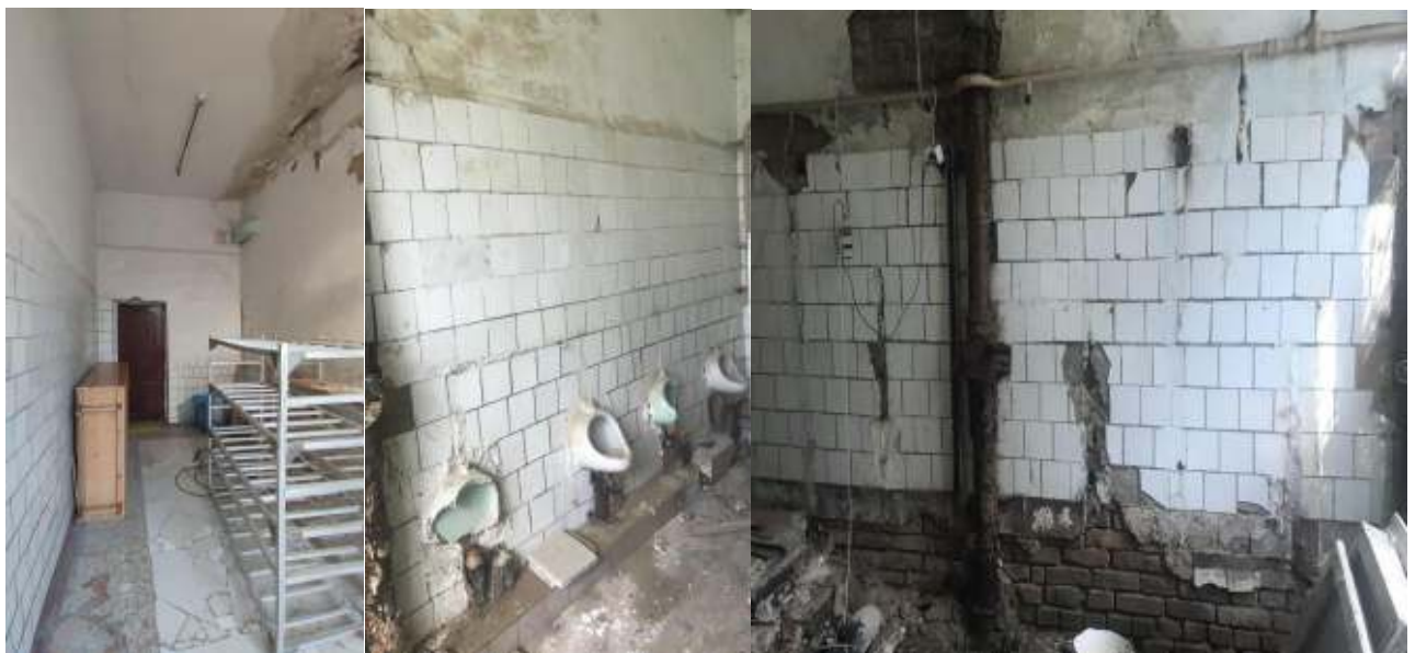
Рисунок 10.1 - Туалет першого поверху навчального корпусу №2 до початку виконання капітального ремонту
