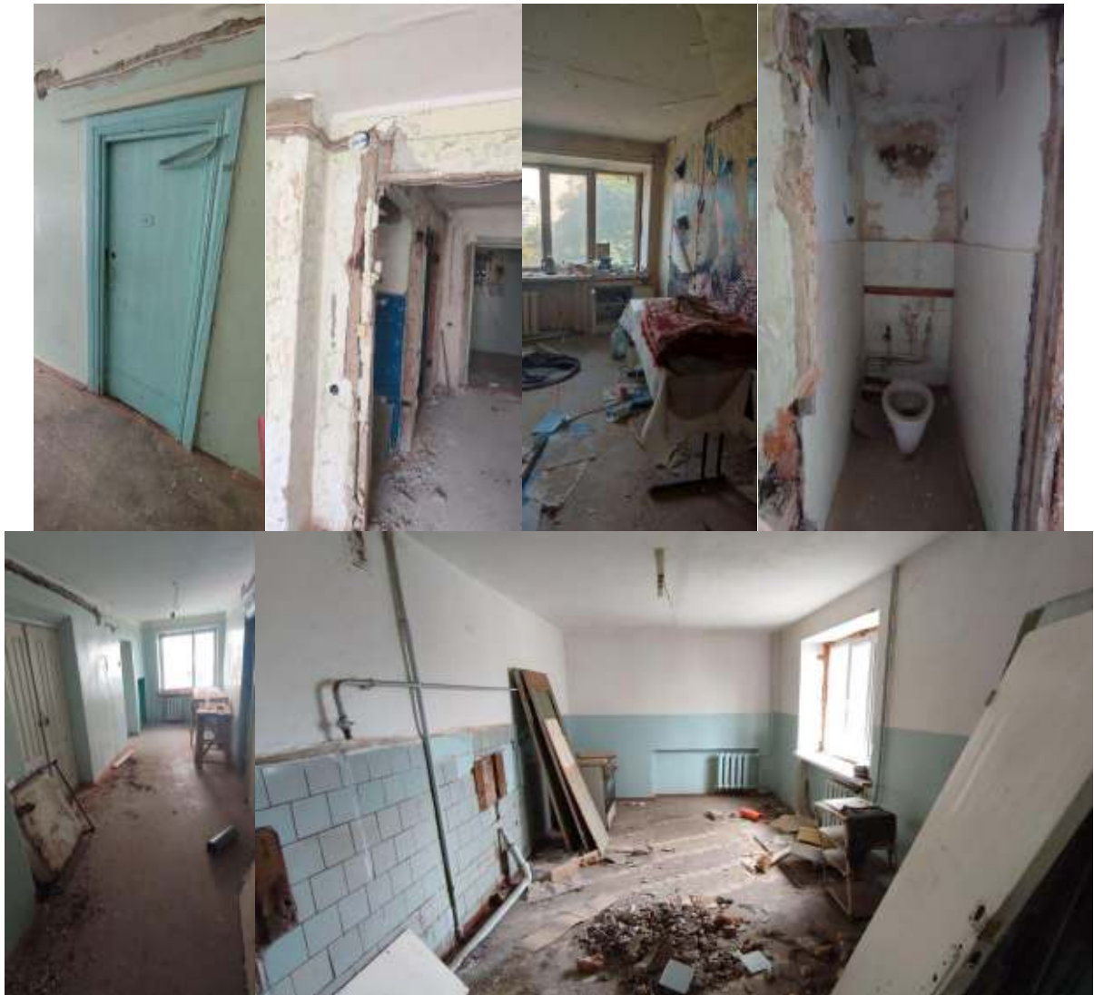
Рисунок 10.3 Стан приміщень 5 поверху гурт. №3 до початку виконання ремонтних робіт
